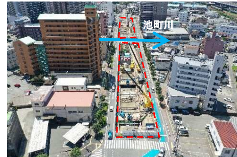
池町川(地下調節池)
