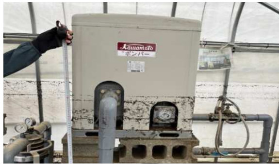
冠水した給水ポンプ (朝倉市)
