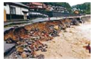
〈被災した道路〉
