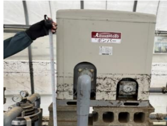
冠水した給水ポンプ(朝倉市)
