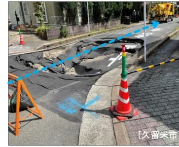
下水道の老朽化対策 [久留米市]
