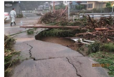
河川施設の被害(福津市(R7))
