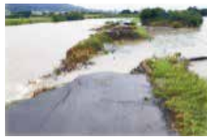
〈巨瀬川の被害状況〉
