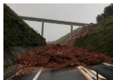
平成30年7月豪雨における被災状況
