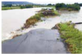
〈巨瀬川の被害状況〉
